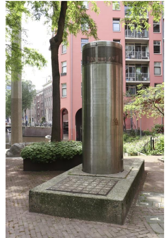
Luchtuitlaat voor de generatoren en de luiken die de lucht in laten.
