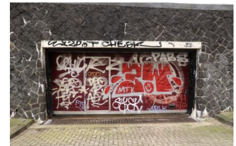
Garage ingang, deze opening zou dicht gemaakt worden.
