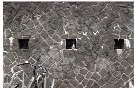
Luchtuitlaten van de Schuilplaats.
